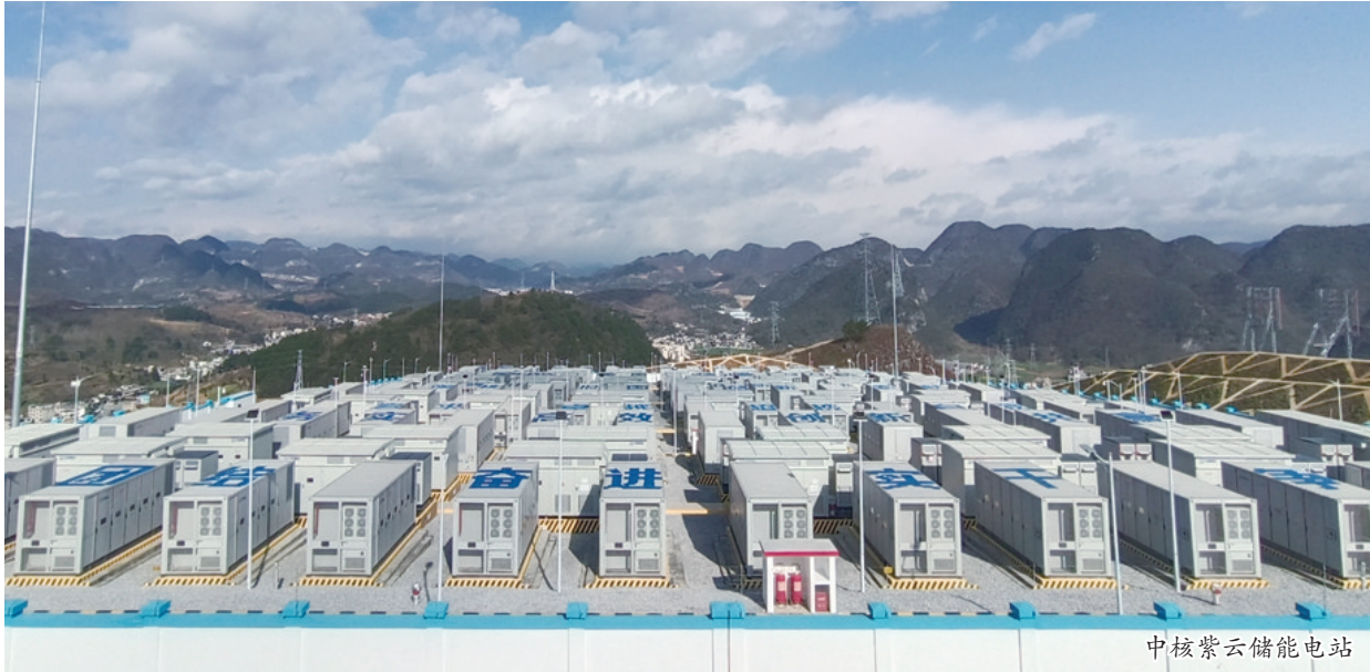
中核紫云储能电站
