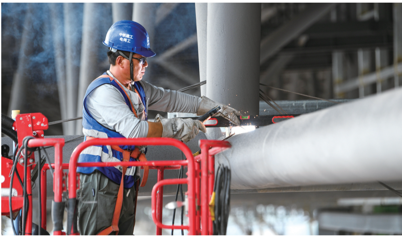
8月17日,中铁建工人在重庆东站站房及配套综合交通枢纽工程二标段项目作业。
