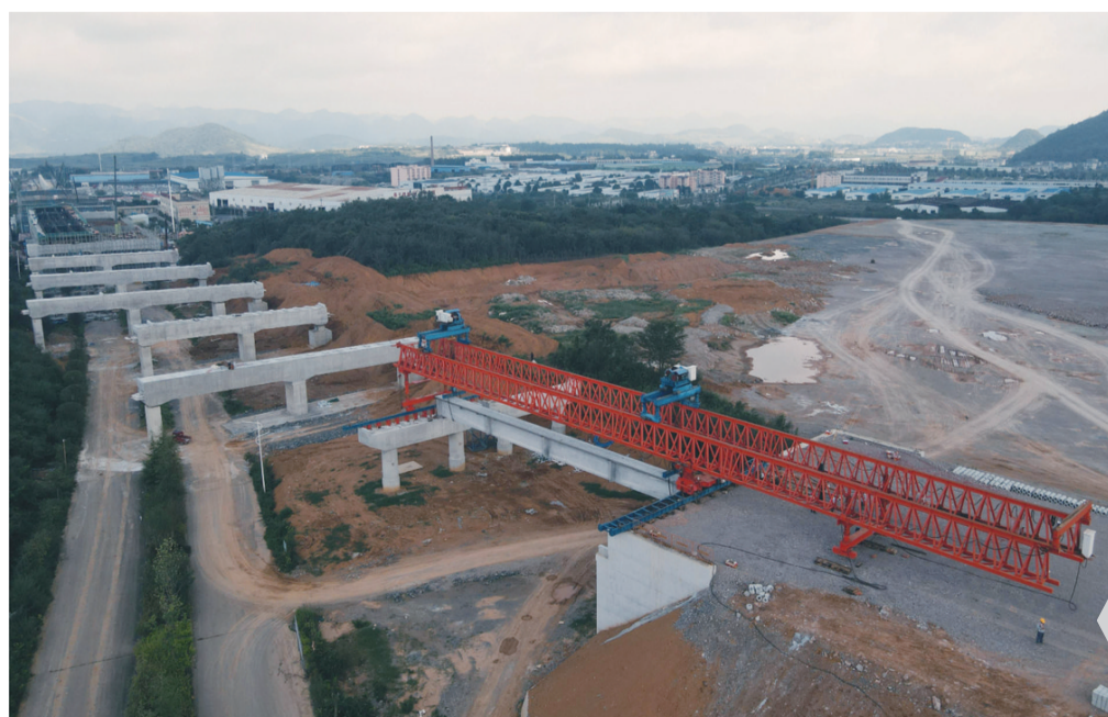
8月7日，在安盘高速公路1标的控制性工程普定特大桥施工现场，伴随着机械的轰鸣声，首片预制T梁稳稳落在墩柱上顺利完成架设，标志着安盘高速1标项目正式由桥梁下部结构施工转向上部结构施工阶段。 □记者 鲁开伟 摄
