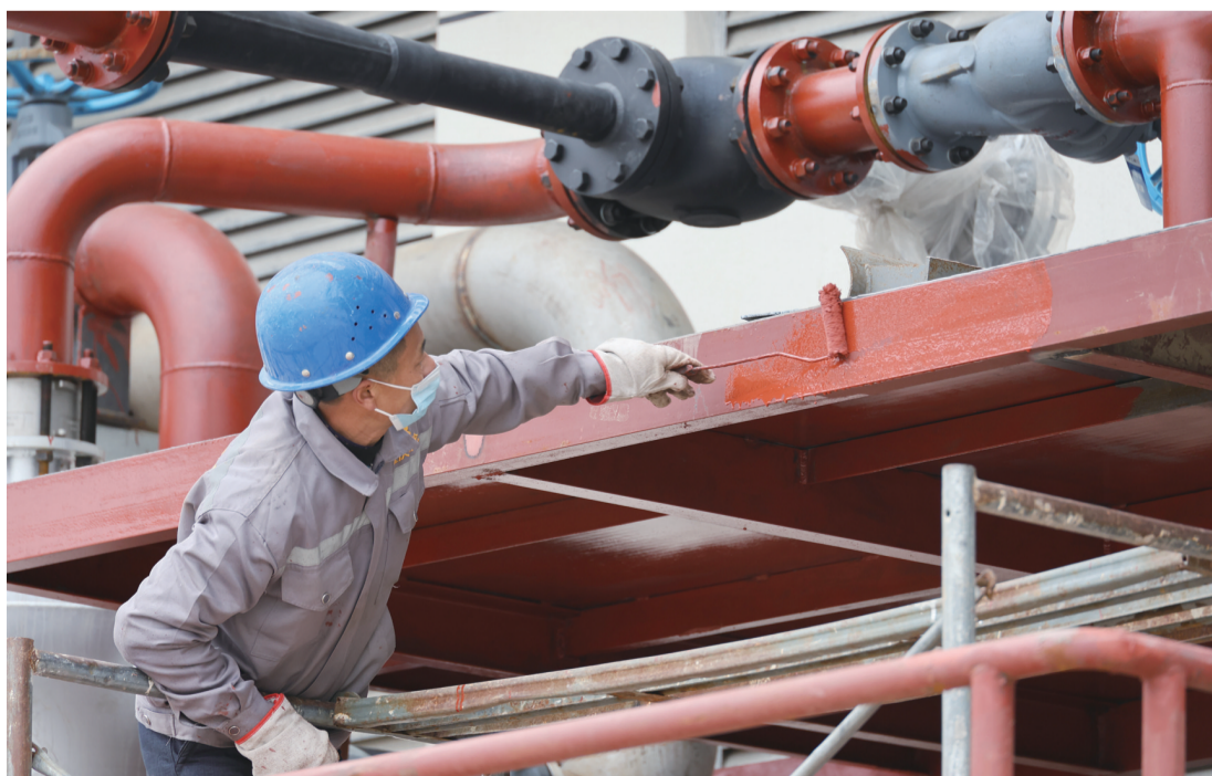
2月22日,在位于安顺经开区的贵州百灵企业集团制药股份有限公司,贵州百灵扩能技改项目施工现场繁忙有序,该项目自大年初四复工复产以来,每天有近80人在现场作业,铆足干劲,奋力冲刺一季度“开门红”。据悉,该项目总投资达59793.5万元,主要包括建设甲类提取车间、丙类提取车间、前处理车间、中药材仓库、危品库、罐区等区域。图为工人正在为建设中的丙类车间设备平台焊接处刷漆。 □记者 唐琪 摄
