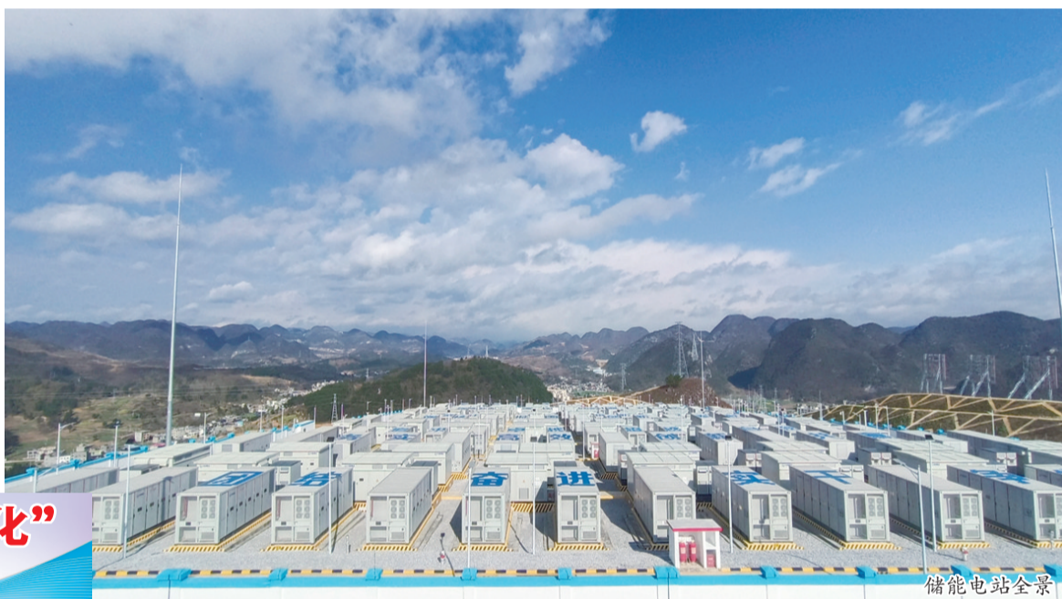
储能电站全景
