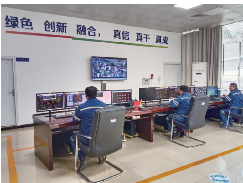
水电站工作人员在严密监视机组运行情况
