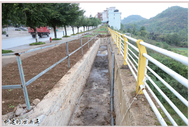
新建的泄洪渠
