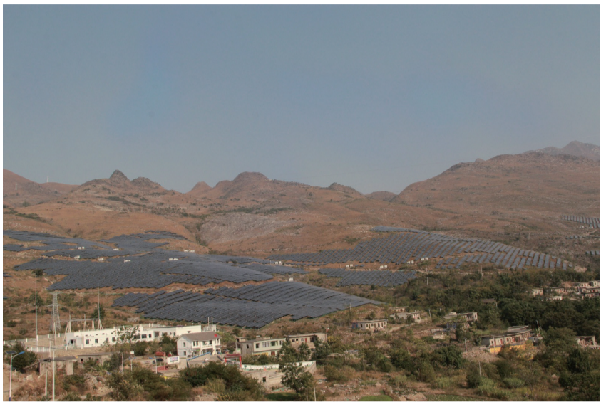
江西坪村旁山坡上光伏发电
