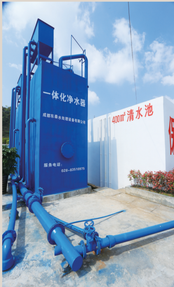
蔡官镇水务公司一体化净水器保障集镇供水、农村人饮
