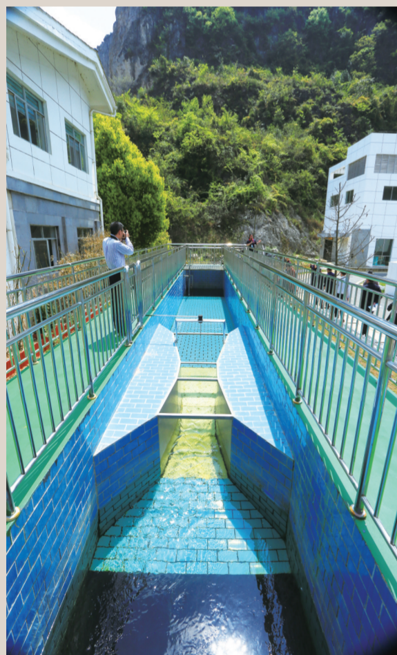
安顺市污水处理厂出水口水质优良
