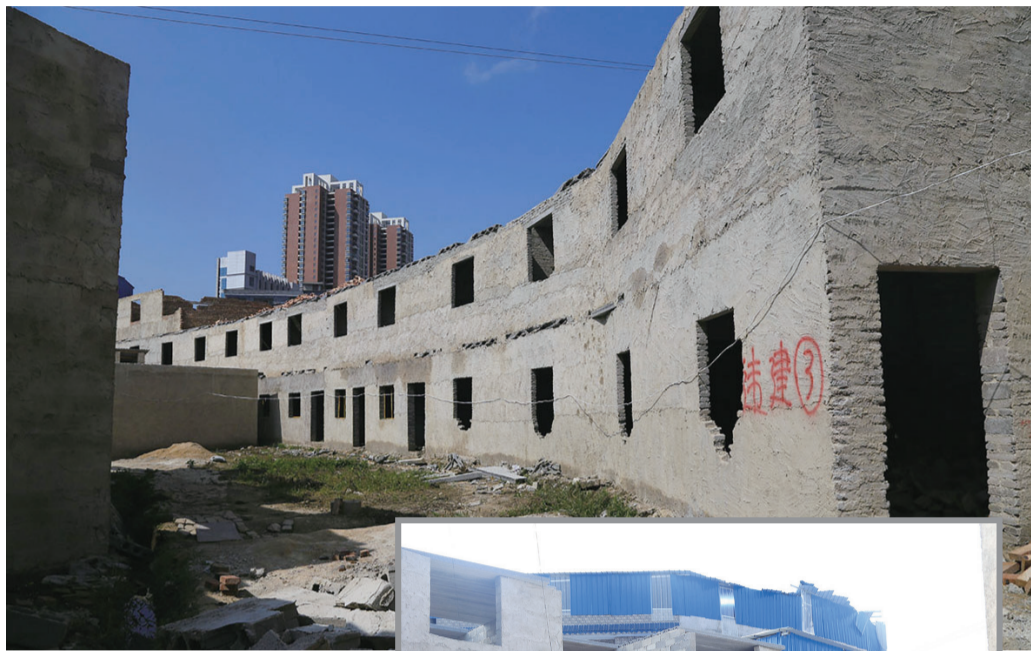
大水沟村成排的违建房屋
