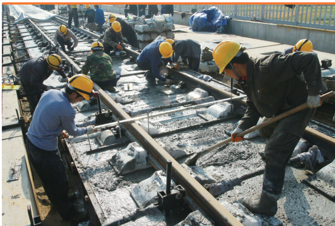
为确保国家重点工程——沪昆客专贵州西段按期开通,参加该重点工程施工的中铁十四局集团公司沪昆客专贵州工程指挥部第二项目部近千名建设者,日以继夜奋战在施工一线。图为五一小长假期间,测量人员对已经打好的道床板的每一根轨枕进行认真细致的精调。
