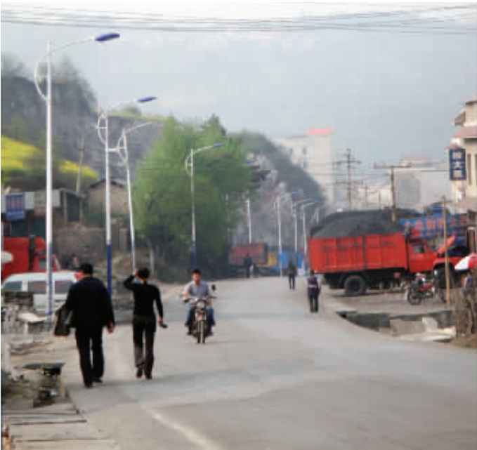
新安装的路灯即将投入使用。
